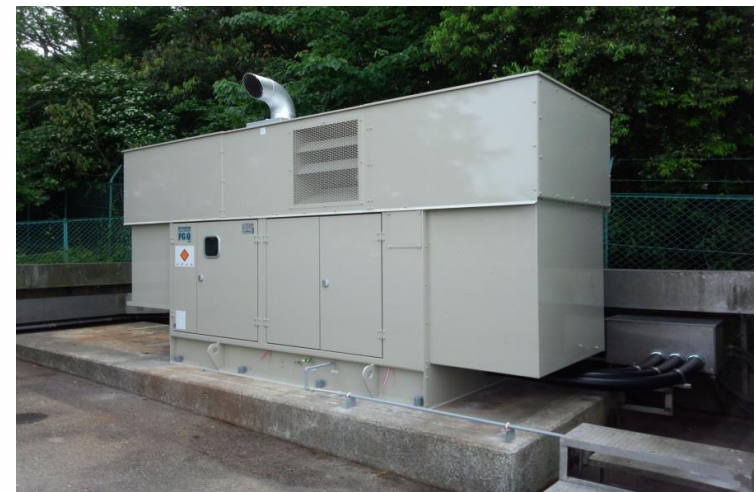
敷地内に自家発電装置を完備
